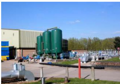
Waterzuiveringsinstallatie voor hergebruik regenwater in Engeland (Foto: Des Blenkinsopp)
