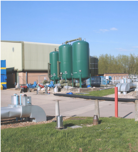
Waterzuiveringsinstallatie voor hergebruik regenwater in Engeland (Foto: Des Blenkinsopp)
